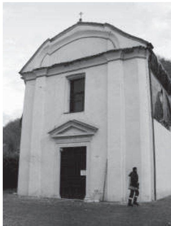
Clibbio, San Lorenzo. Prospetto principale: è evidente il quadro fessurativo che interessa la parte superiore della muratura.
